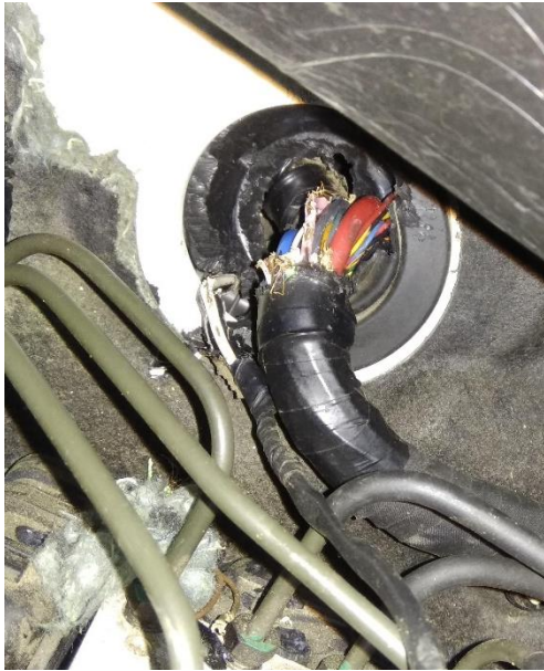
실내 연결 배선 피복 손상
